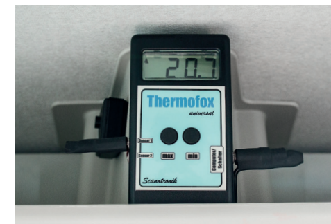
PERFEKTES RAUMKLIMA durch Temperaturüberwachung des Pferderäumes
